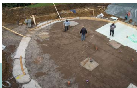
Nach dem Unterfangen des bestehenden Gebäudes starteten die Arbeiten mit dem Gießen der Fundamente für die Außenhaut.
